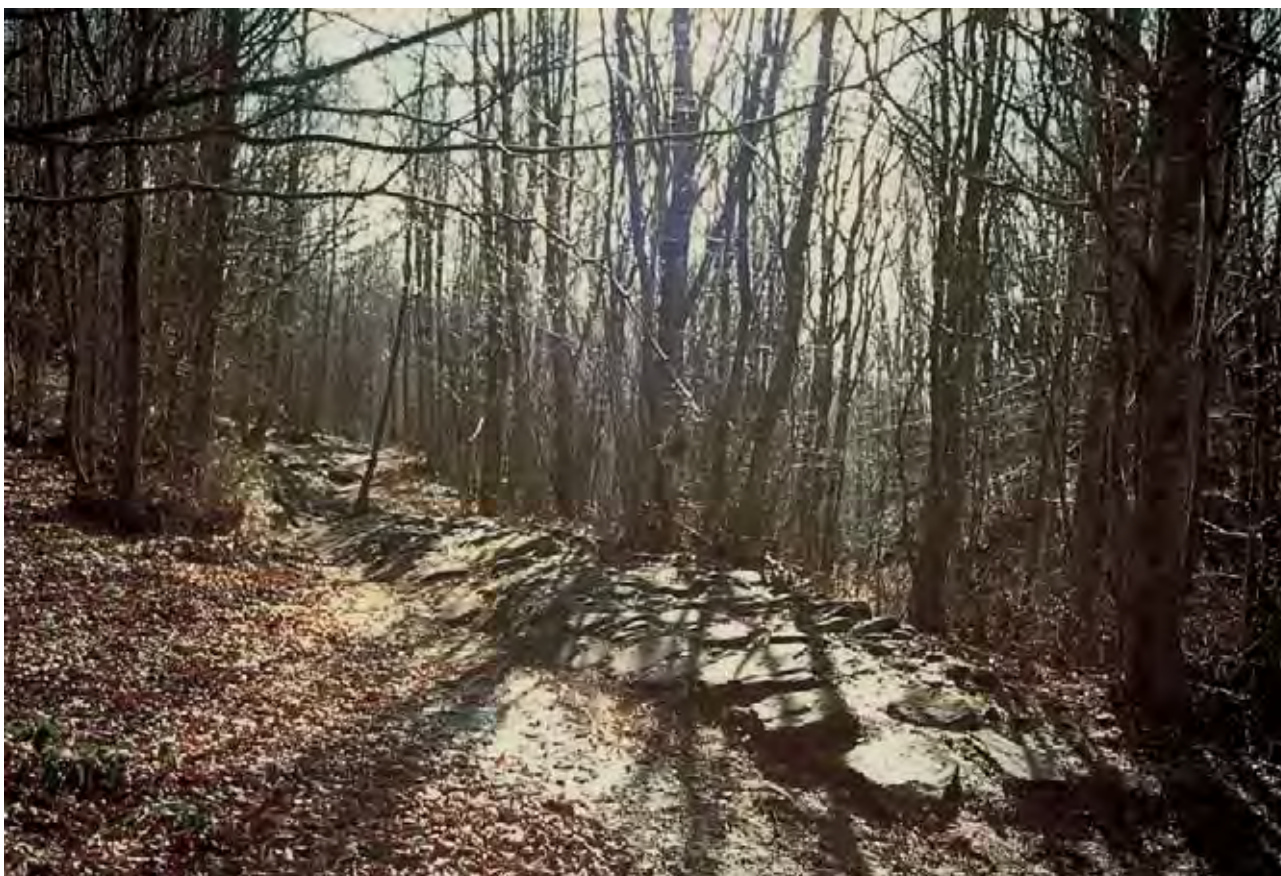
Monte Bastione (sito A/2-direzione sud): la pavimentazione deformata da una frana superficiale.
